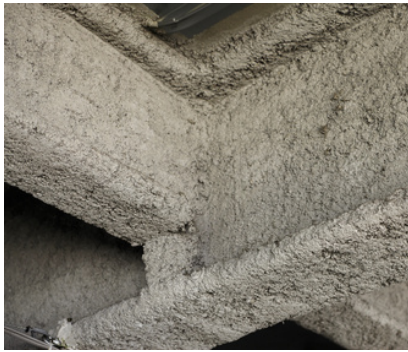
Abb. 3: Weltweit findet man Asbest noch als Spritzasbest, ...
