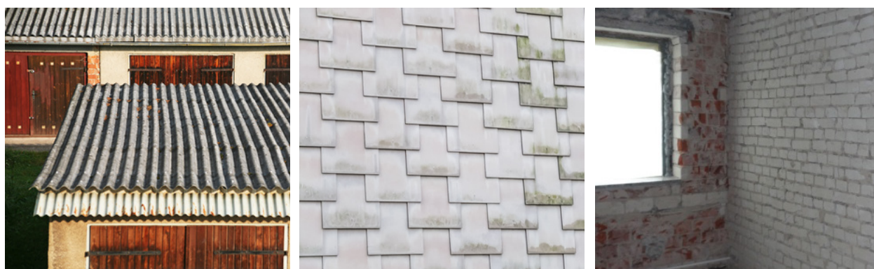
Abb. 15: In der Nähe von intakten Asbestdächern ist keine zusätzliche Faserbelastung messbar. Daher können unbeschädigte Dächer erhalten bleiben, ebenso gut erhaltene Fassadenschindeln.
